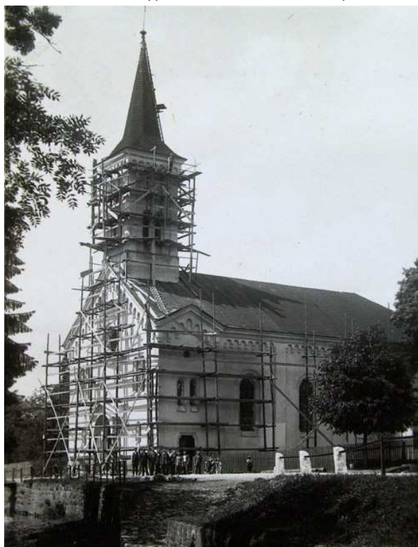
Oprava kostela v roce 1932. Tenkrát stála 16607,60Kč. V brzké budoucnosti plánovaná oprava střechy věže bude o něco dražší... :-)
